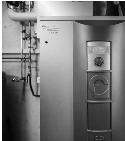
Heizen per Wärmepumpe
