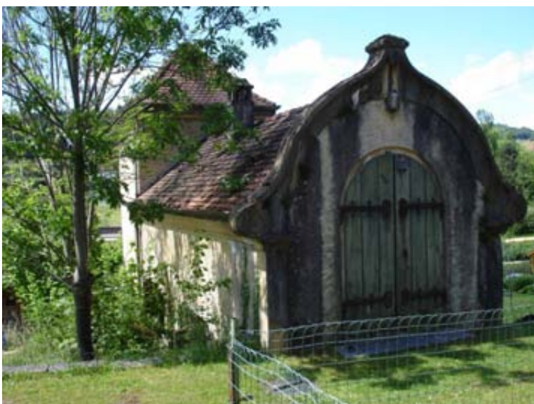
13. Trafostation, Waschhaus-Obergeschoss, Ost und Nordseite
