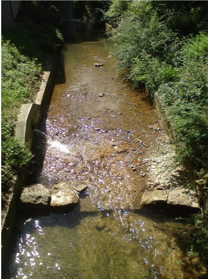
Abbildung 1 Abschnitt Lüdinpark: Kiessohle mit Blockschwellen
